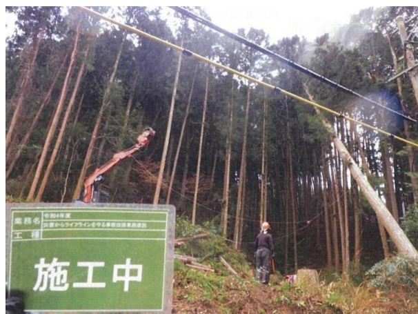
写真4 事前伐採(施工中)電線近接部における高性能林業機械(スイングヤード)使用状況
