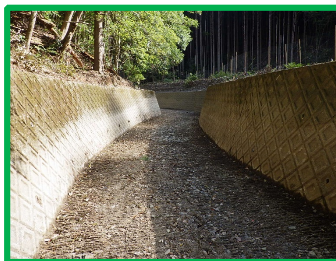
流木撤去後（紀北町）
