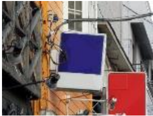
上部構造全体が傾斜した状態
