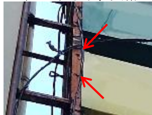
ボルトのゆるみや欠落した状態
