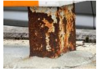
支柱根元の腐食が進行した状態
