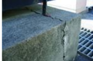
基礎にクラックが入った状態
