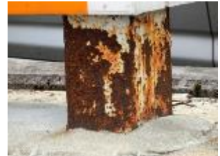
支柱根元の腐食が進行した状態
