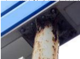
接合部（溶接部）が腐食している状態
