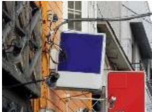
上部構造全体が傾斜した状態
