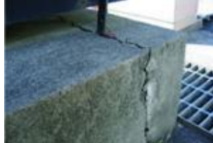
基礎にクラックが入った状態
