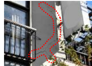
壁面にひびが生じた状態
