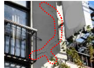
壁面にひびが生じた状態
