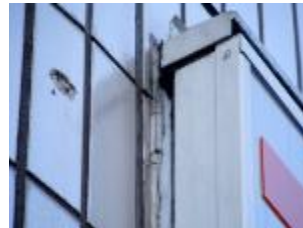
コーキングが劣化した状態
