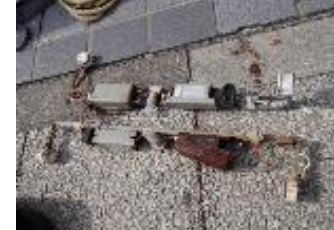
変圧器（トランス）のさびが進行した状態
