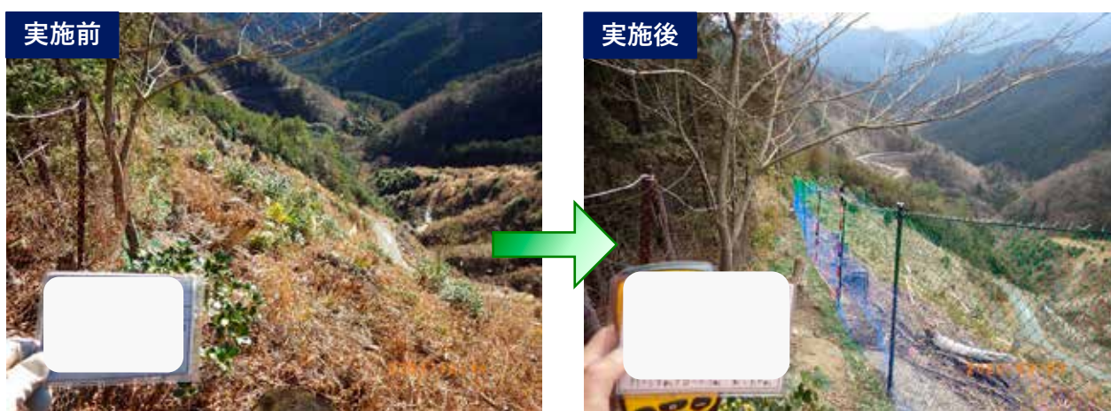
獣害防止施設の設置状況（松阪市）
