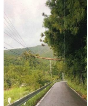
配電線の倒木被害例
