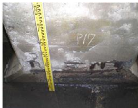
柱の鉄筋露出
