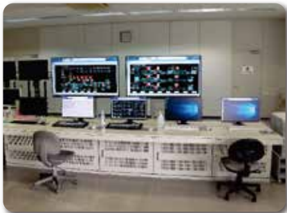
更新した中央監視制御設備
