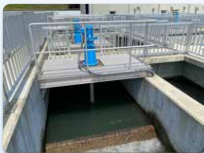
[急速かくはん池]
