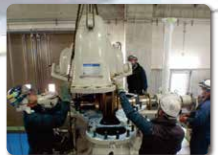
分解点検中のポンプ設備
