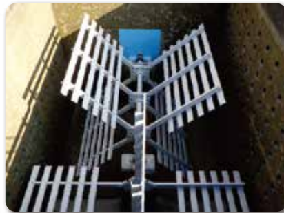
更新した浄水場の緩速攪拌機
