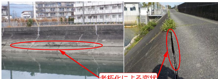
老朽化による変状
