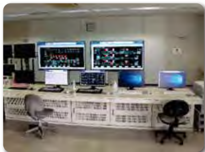
更新した中央監視制御設備
