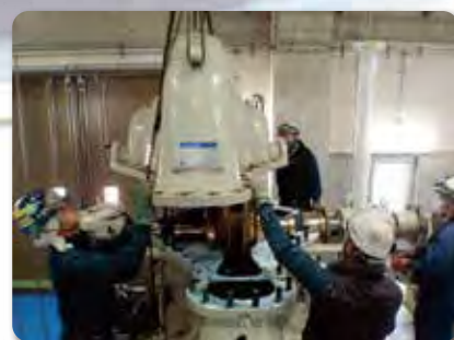
分解点検中のポンプ設備
