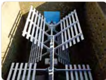
更新した浄水場の緩速攪拌機
