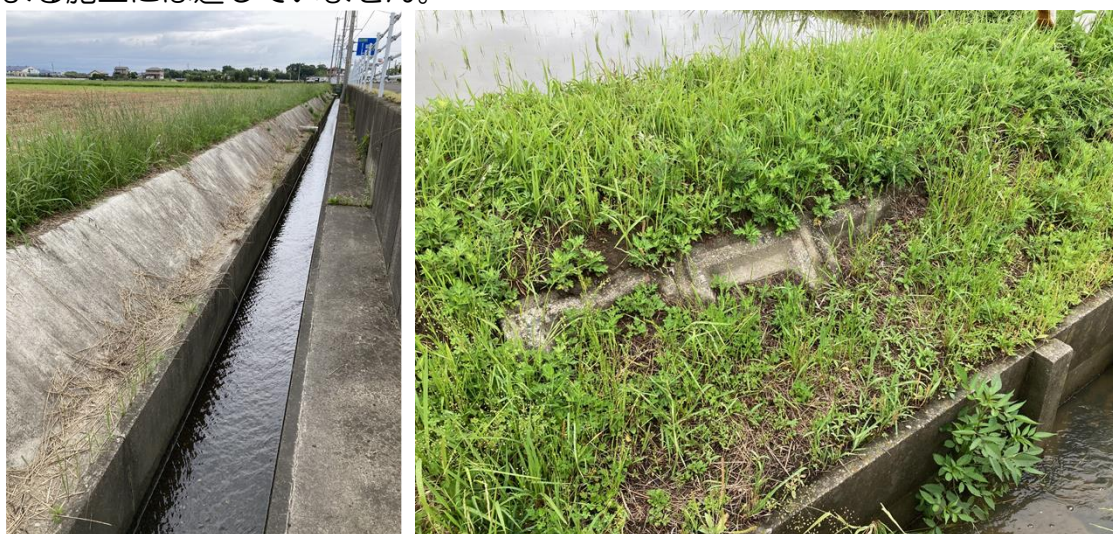
図8 施工に適さないほ場の例
