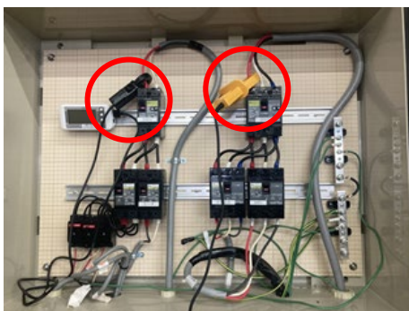
電力測定機器の設置状況
