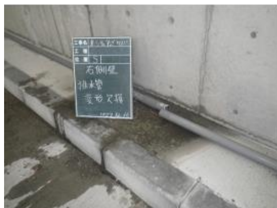
排水管の変形・欠損
