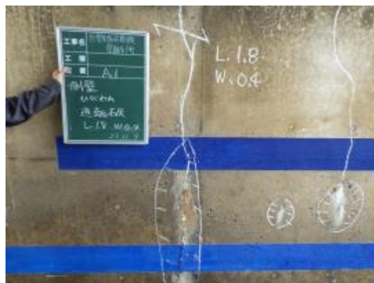
側壁のひび割れ
