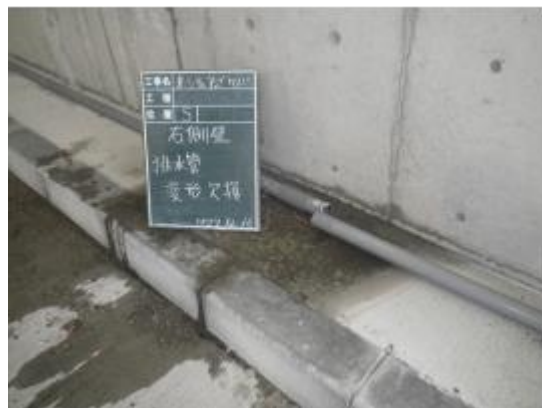
排水管の変形・欠損
