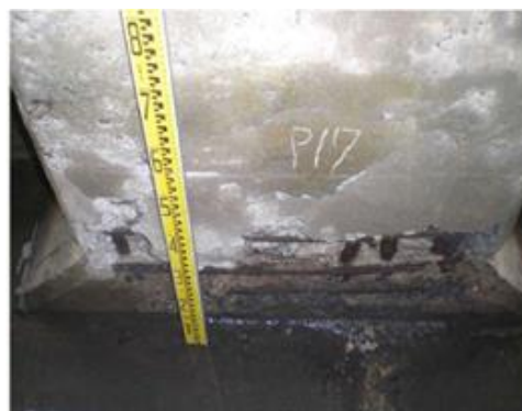
柱の鉄筋露出
