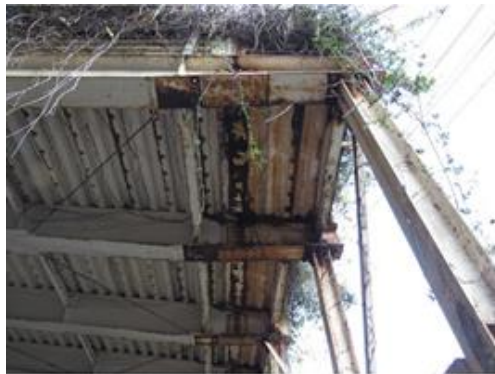
主梁・横梁・頂版の腐食
