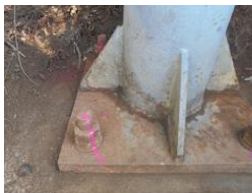
ベースプレートの腐食
