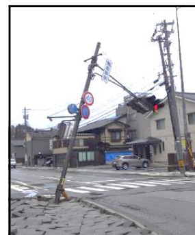
【信号機の傾斜状況（能登半島地震）】
