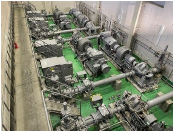
分解点検予定の菰野導水ポンプ所 導水ポンプ設備（菰野町）
