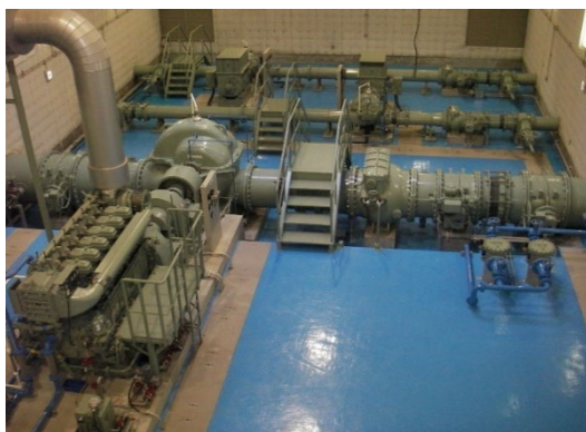
分解点検予定の山村ポンプ所 取水ポンプ設備（四日市市）
