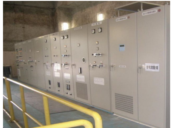
更新予定の山村ポンプ所電気設備 （四日市市）
