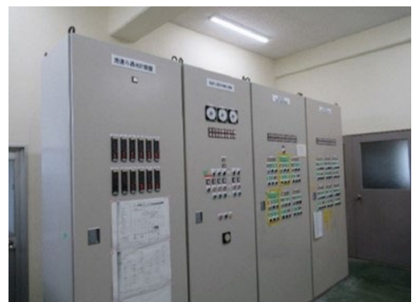
更新予定の水沢浄水場ろ過池制御設備 （四日市市）
