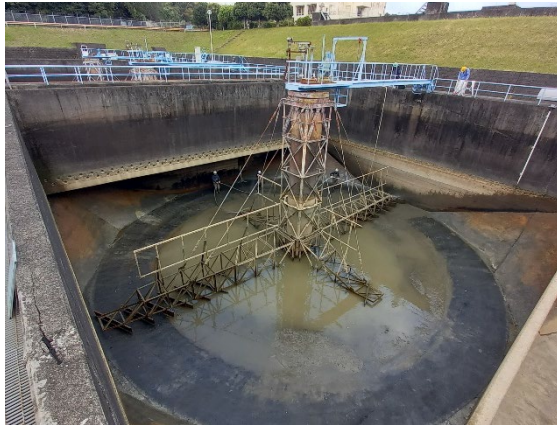
更新予定の山村浄水場汚泥池掻寄機 （四日市市）
