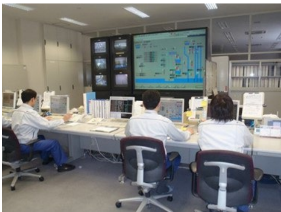
更新予定の北勢水道事務所統括監視制御設備 （四日市市）
