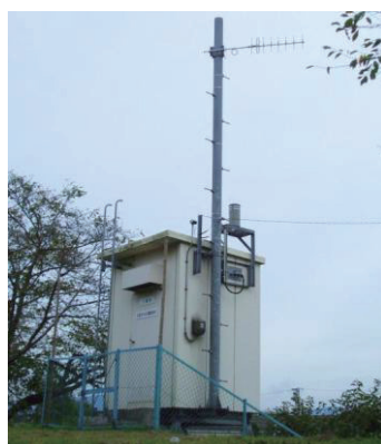
雨量・水位観測局
