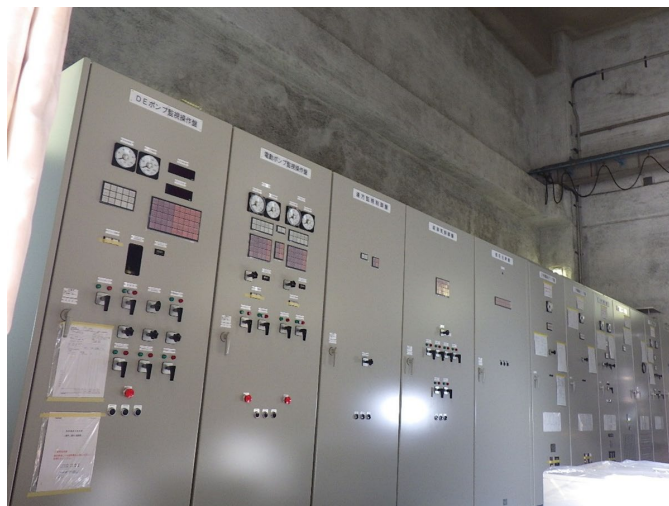
更新が完了した山村ポンプ所 電気設備（四日市市）
