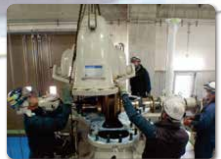
分解点検中のポンプ設備
