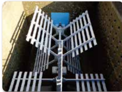
更新した浄水場の緩速攪拌機
