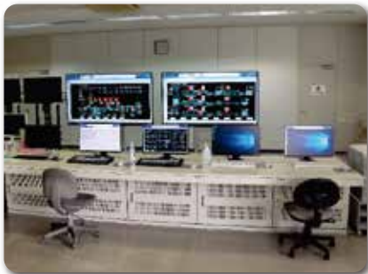
更新した中央監視制御設備
