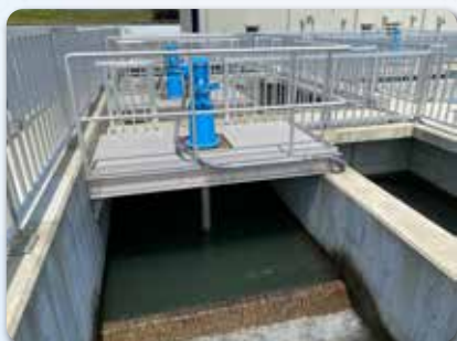
[急速かくはん池]
