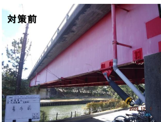
塗装劣化、地覆欠損
