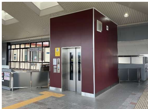
鉄道駅に設置されている エレベーター（南が丘駅）
