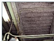
石綿含有吹付けロックカウル
