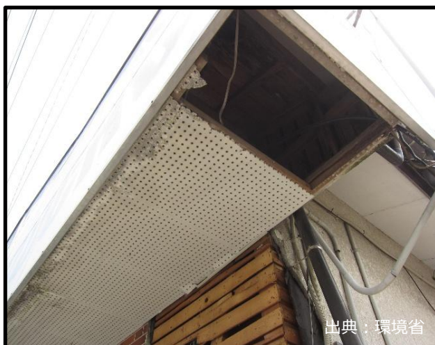
地震で破損した石綿含有成形板
