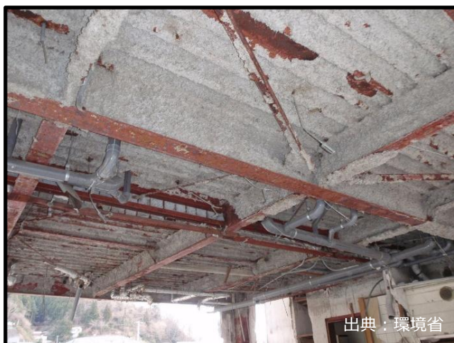
津波で露出した石綿含有吹付け材
