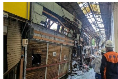
焼損した商店街の内部
