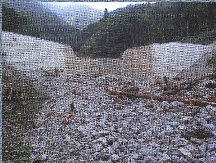
■ 西之貝戸川2号えん堤と土石流堆積物（平成14年7月18日撮影）
