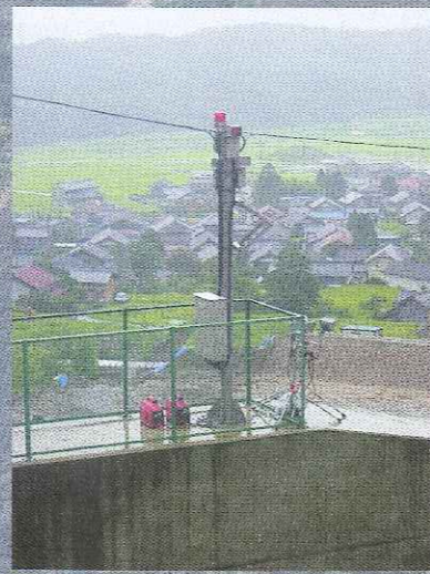
■小滝川1号えん堤に設置されている警報機
