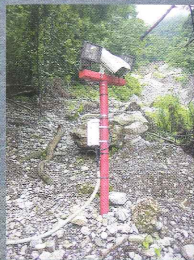
■西之貝戸川の上流に設置されている監視カメラ
