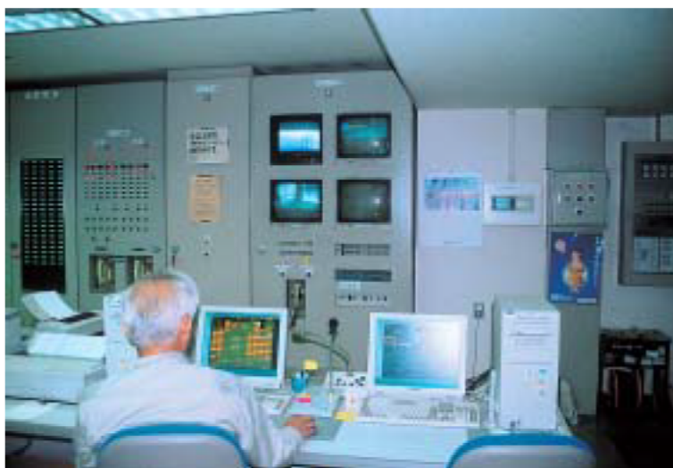
本庁の中央監視室
