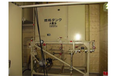
自家発電機用サービスタンク(本庁舎)
