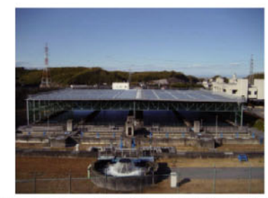
播磨浄水場太陽光発電設備(桑名市)
