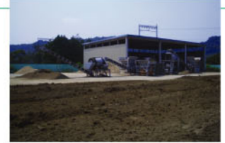
グラント改良材の製造(高野浄水場・津市)
