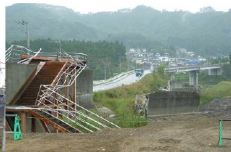
津波で破壊された防潮堤
