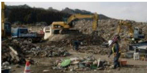
災害廃棄物処理の状況
