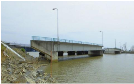
被災した定川大橋の全景
