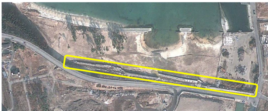
(山田町浦の浜の破壊された海岸堤防（黄色枠内）と隣接する町道）
