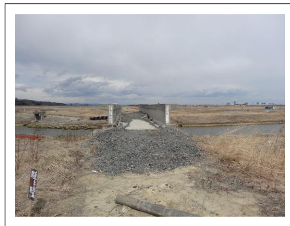
橋梁のみを残して流出した常磐線（亘理郡山元町にて） 平成 24 年 4 月 6 日
