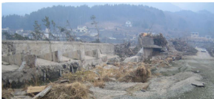
(山田町浦の浜地区の破壊した海岸堤防)
