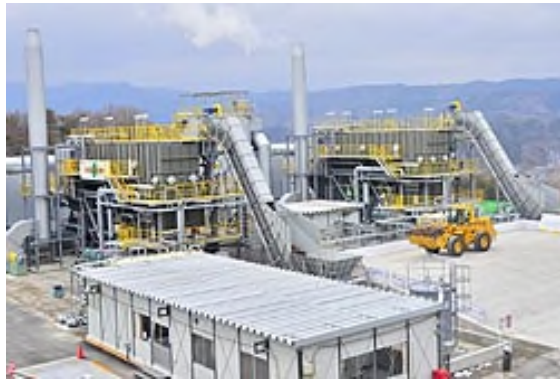
図 仮設焼却炉（岩手県宮古市）
