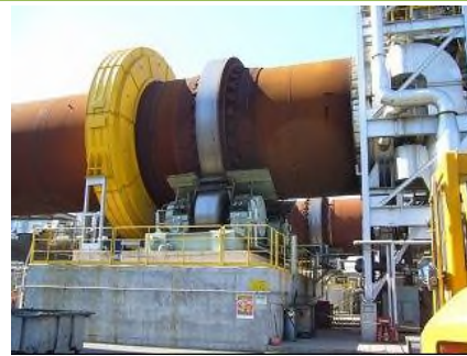
▲石巻ブロックのロータリーキルン
