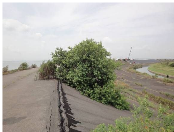
(写真2) 堤防にできたひび割れから草木が生えている。
