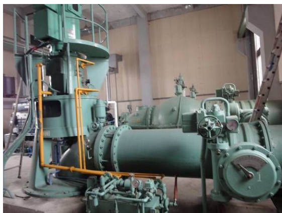
(写真1) 排水機場内部
