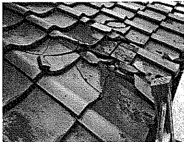
猿に壊された屋根瓦
