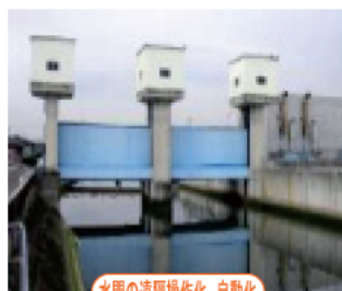
水門の遠隔操作化、自動化
