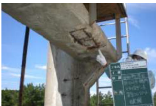
破損 (スライドゲート) 資料：三重県
