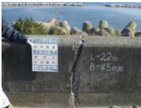
波返し工ひび割れ (三重県鈴鹿市) 資料：三重県
