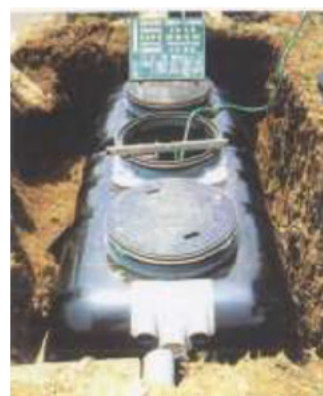
合併処理浄化槽
