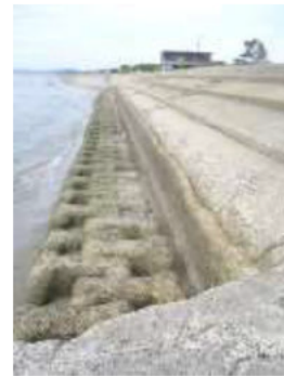
老朽化している海岸堤防 (愛知県美浜町)
