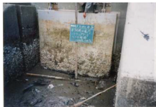
ヘドロの堆積 (フラップゲート) 資料：三重県
