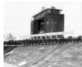
深い基礎を持つ水門と堤防の不等沈下（愛知県と三重県の県境）
