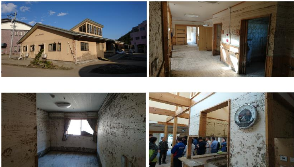
被災した高齢者福祉施設の様子
