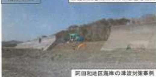
阿田和地区海岸の津波対策事例
