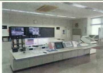
改良予定の中央監視制御装置 （大里浄水場）
