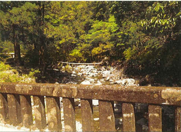
写真9 大内山池ノ谷越地内（危険木伐採撤去前）
