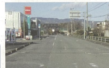
交差点部区画線の劣化状況
