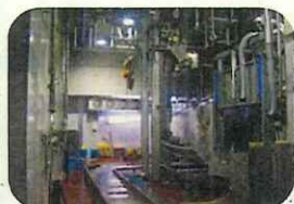
食肉センター内の加工設備
