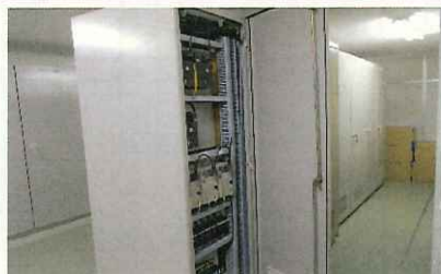
改良予定の遠方監視制御設備 (高野浄水場遠方監視制御設備)
