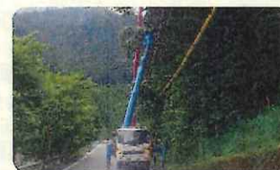
電線沿いの危険木の事前伐採
