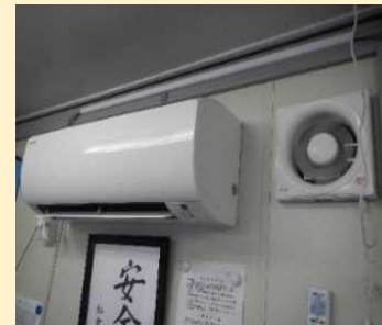
扇風機や換気扇とエアコンを併用
