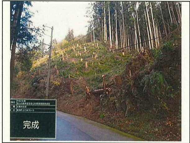
写真2 森林整備(完成)松阪市飯南町上仁柿地内 倒木による孤立集落化の懸念が解消された。
