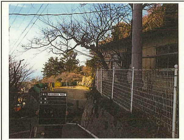
写真9 危険木伐採事業業務委託（神島地区）【施行前】
