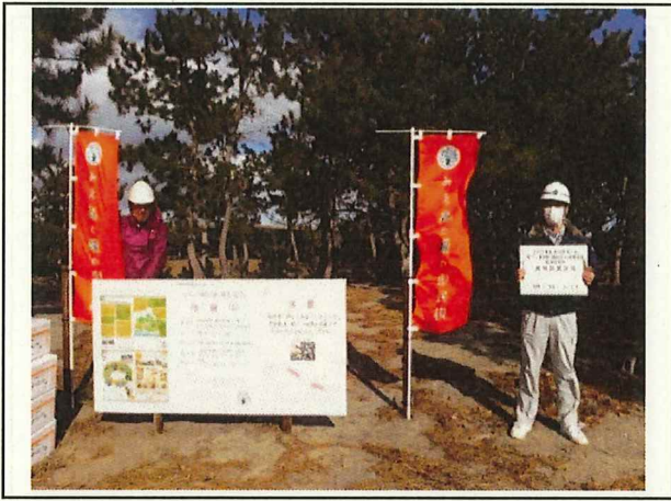
写真9 PR看板設置状況
