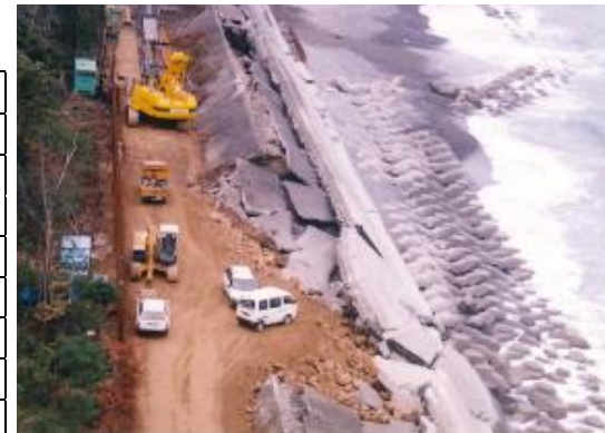
井田地区海岸平成9(1997)年被災状況
