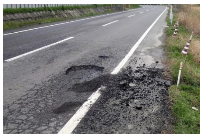
舗装のひび割れ状況
