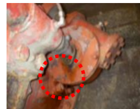
(低水放流設備の漏油状況)
