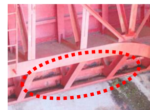
(放流ゲートの発錆状況)
