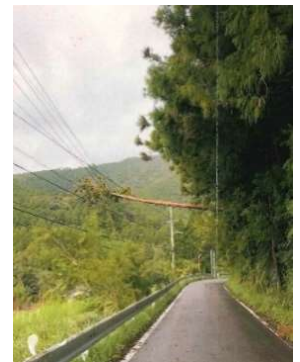
配電線の倒木被害例
