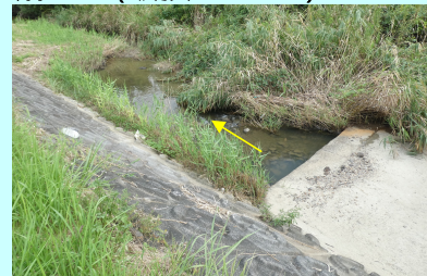
中流域: 近鉄橋梁下流の 落差工(破損している)
