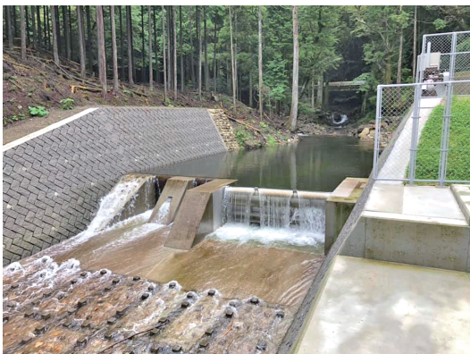
＜馬野川小水力発電施設（取水口）＞
