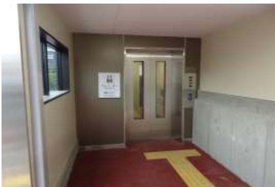
鉄道駅に設置されている エレベーター（桜駅）
