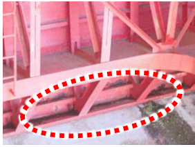
放流ゲートの発錆状況
