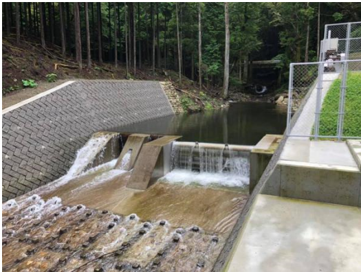
＜馬野川小水力発電施設（取水口）＞
